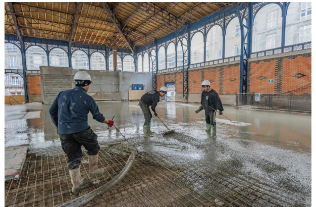
Coulage de la nouvelle dalle béton - novembre 2018 © Ville de Limoges - Laurent Lagarde
